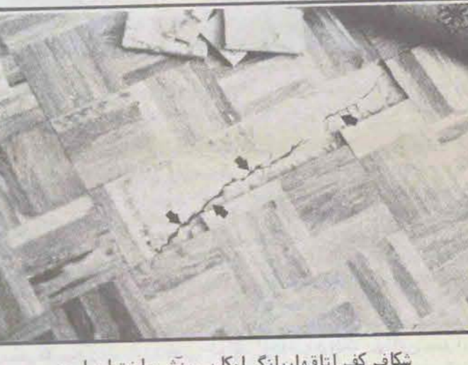
شکاف کف اتاقها بیابانگر ریزش ساختمان است
