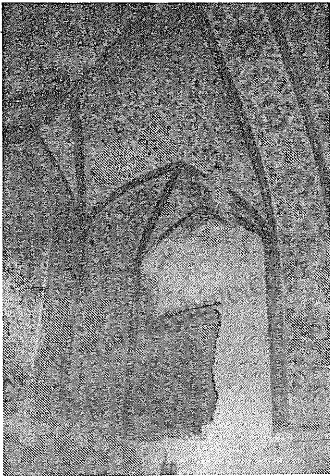
دیوارهای عمارت عالی قاپو که به علت عدم توجه تخریب شده است
